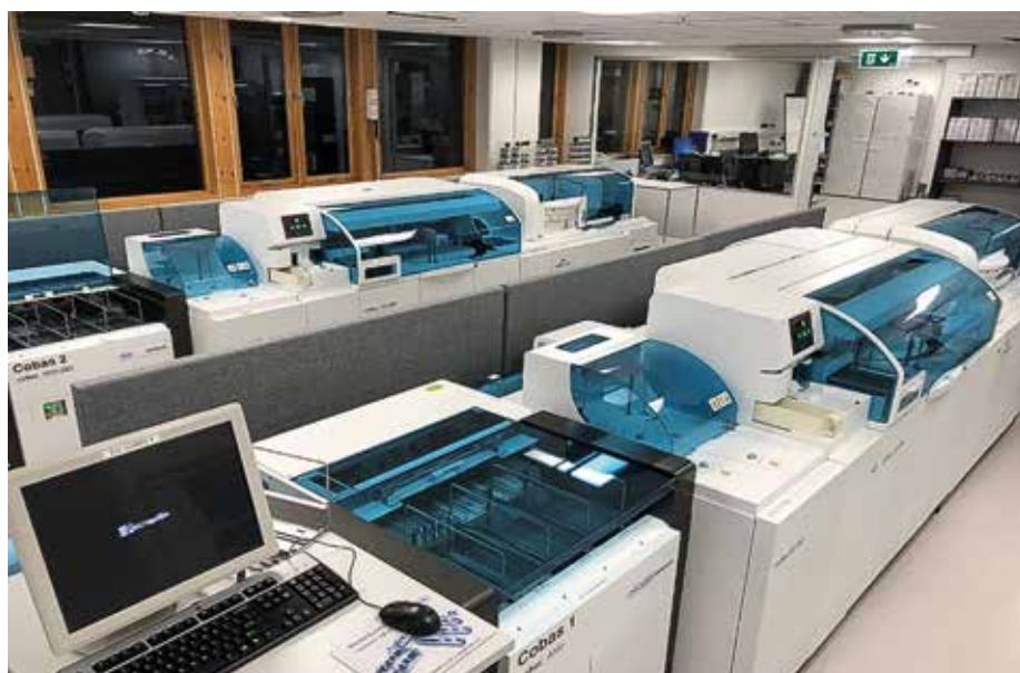
De to Cobas-linjene med valideringsrom i bakgrunnen. De grå veggene bak instrumentene er støyskjermer, og er et av flere støyruserende tiltak..
